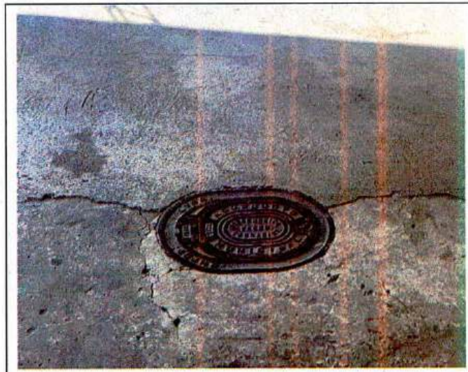
Descripción Vista de contador del agua.
