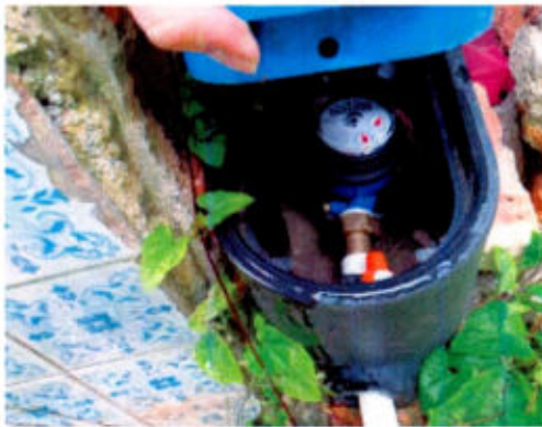
MEDIDOR DE ACUEDUCTO EMPRESA ASOCIACIÓN DE USUARIOS ACUEDUCTO RURAL VEREDA QUEBRADA HONDA
