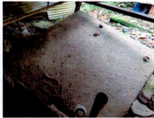
M8 - POZO SÉPTICO
