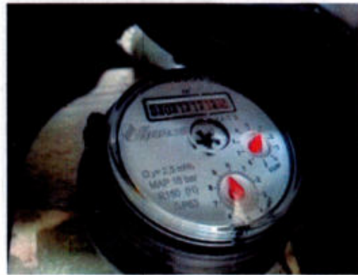
MEDIDOR ACUEDUCTO No. 20295170
