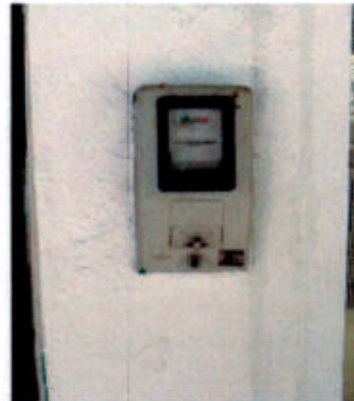
CONTADOR DE ENERGÍA ENEL
