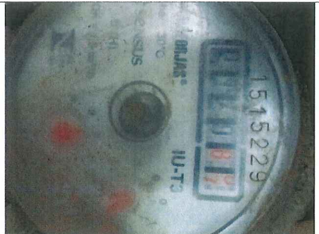
Descripción Vista medidor de agua.
