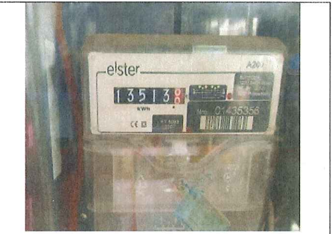
Descripción Vista de medidor de energía
