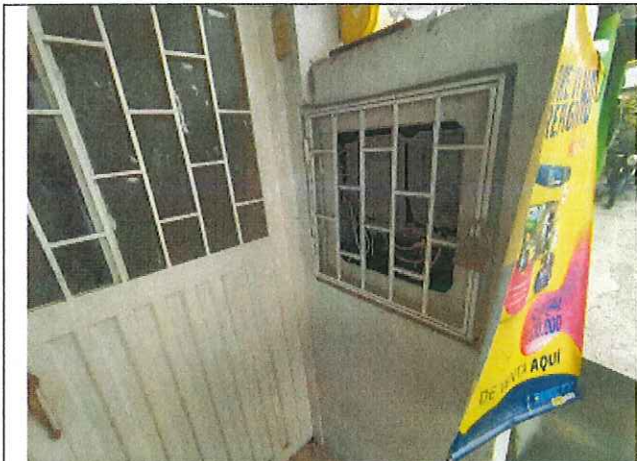
Descripción Vista de medidor de energía
