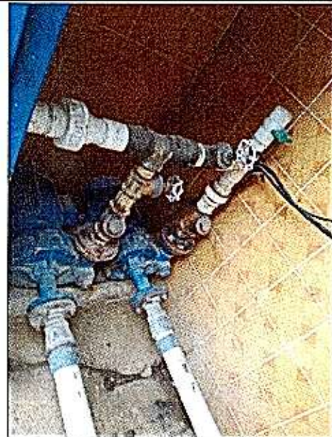
Descripción M2 Cuarto de maquinas
