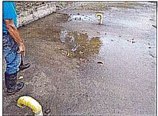
Descripción M1 Planta de tratamiento
