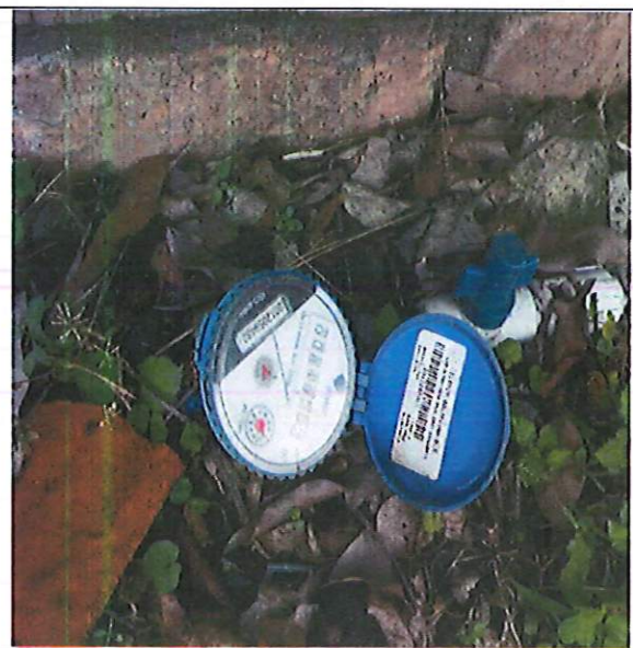
Descripción Vista contador de agua
